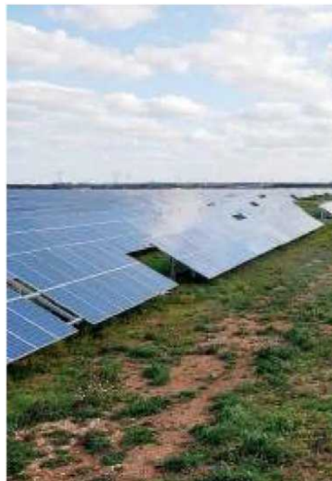
Uno degli impianti fotovoltaici sequestrati
