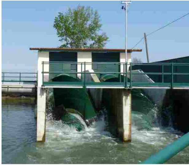
Impianto mini idro ad acqua fluente
