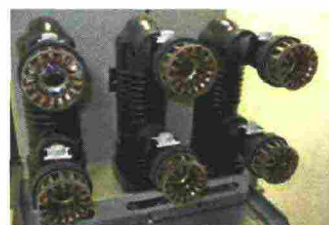
Sensori di temperatura Senseor serie S1 per elettrotecnica, applicati su interruttore mediante velcro
