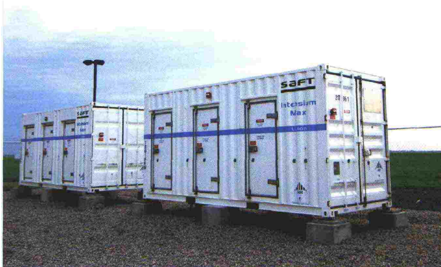
ACCUMULO ENERGETICO APPLICATO ALL'ENERGIA EOLICA IN CALIFORNIA (SAFT)
