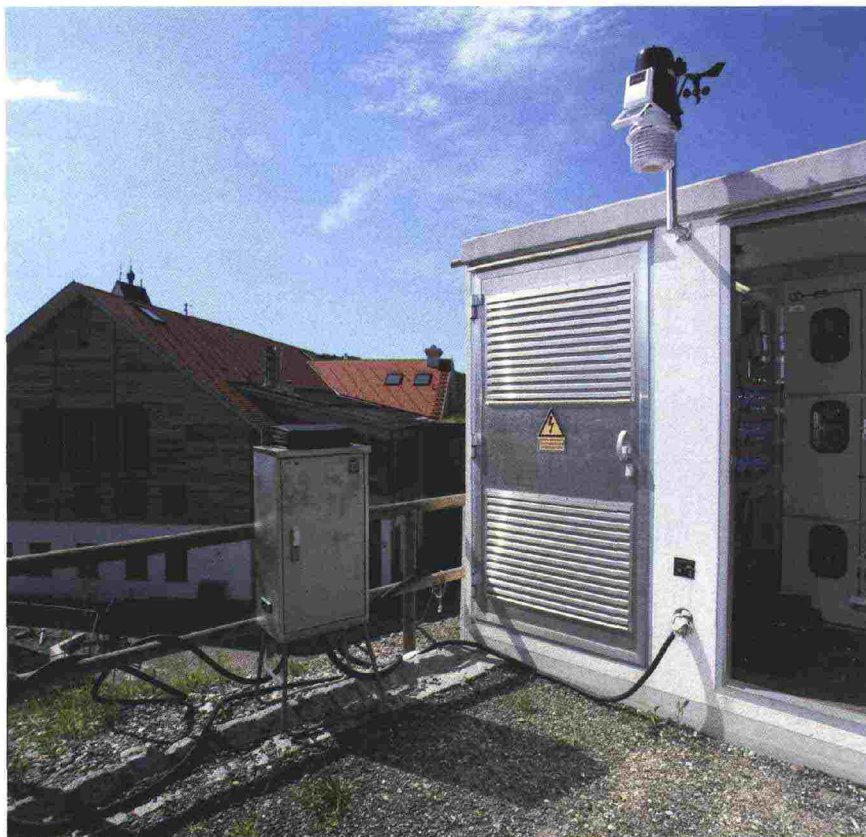
UNA STAZIONE DI MISURA DELLA SMART GRID REALIZZATA NELLA REGIONE DI ALLGAU, IN AUSTRIA (SIEMENS)
