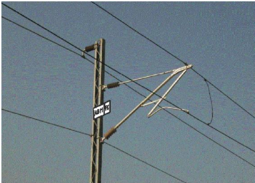
Fig. 4 – Targa identificazione sezioni di linea di contatto applicata al sostegno
