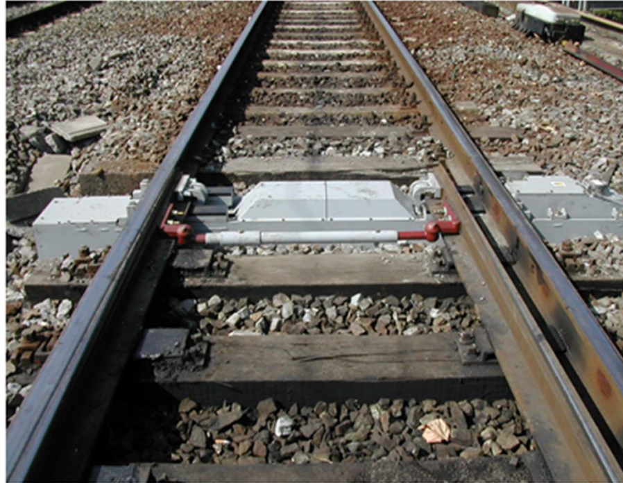
CASSA DI MANOVRA IN TRAVERSA
