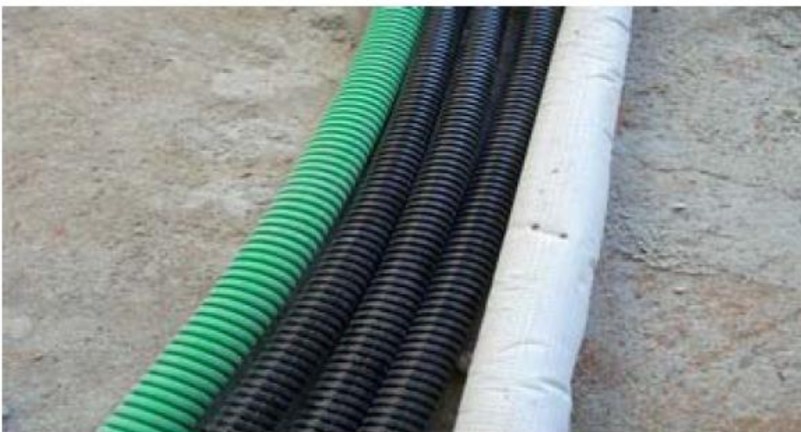
Figura 7 Posa sconsigliata di condutture elettriche: eccessiva vicinanza a condutture idriche
