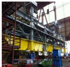
Dolwin 1 800 MW HVDC
