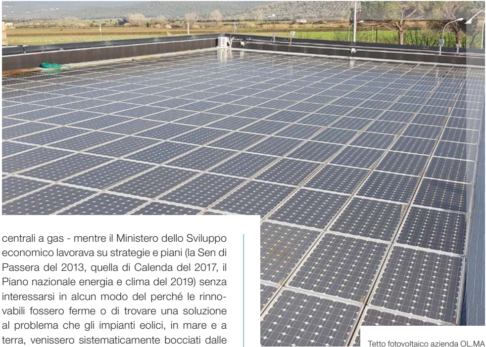
Tetto fotovoltaico azienda OL.MA
