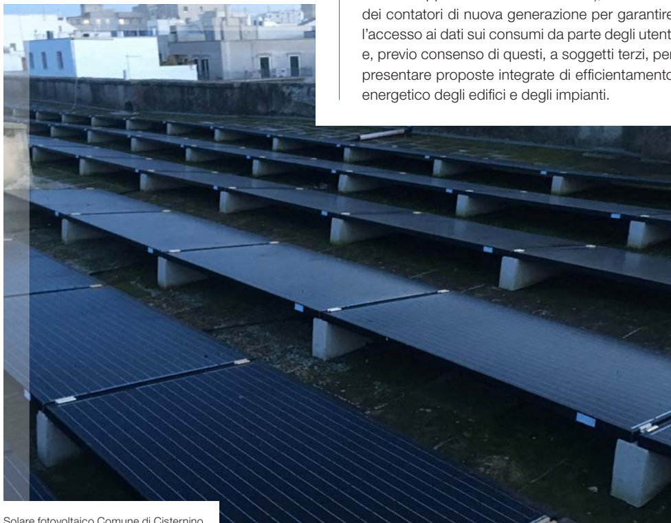
Solare fotovoltaico Comune di Cisternino
