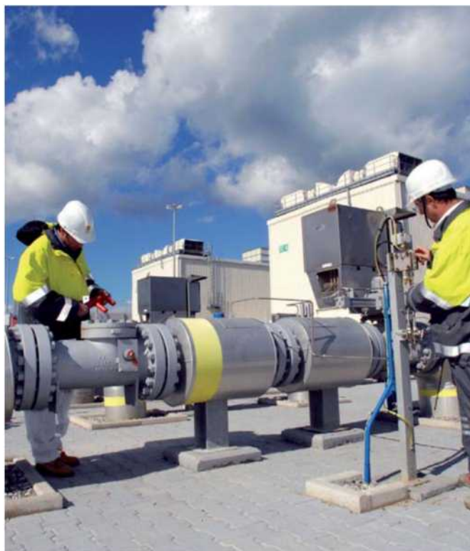
Il riassetto di Snam. Gli impianti del gruppo
