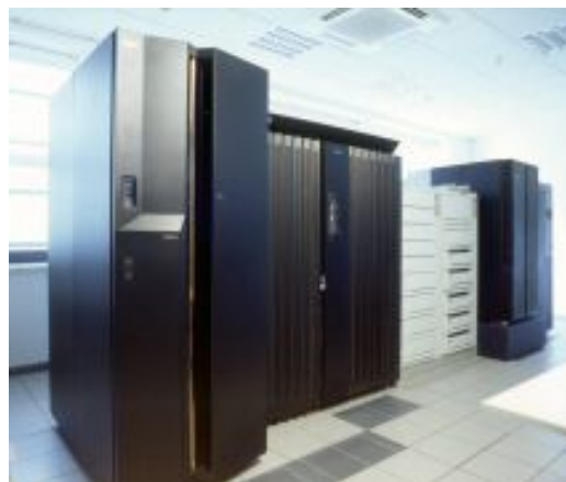
DC di medie dimensioni 20 > 500 KW
