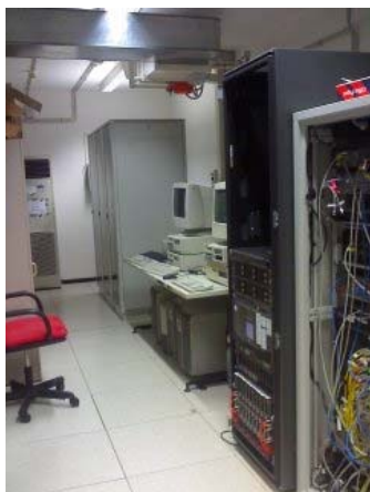
DC di piccole dimensioni 0 > 20 KW
