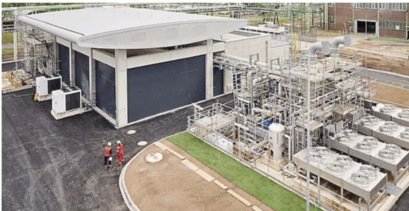
Figura 5.5 - Sito dell'impianto elettrolizzatore di Rhineland da 10 MW in Germania (Fonte: REFHYNE)
