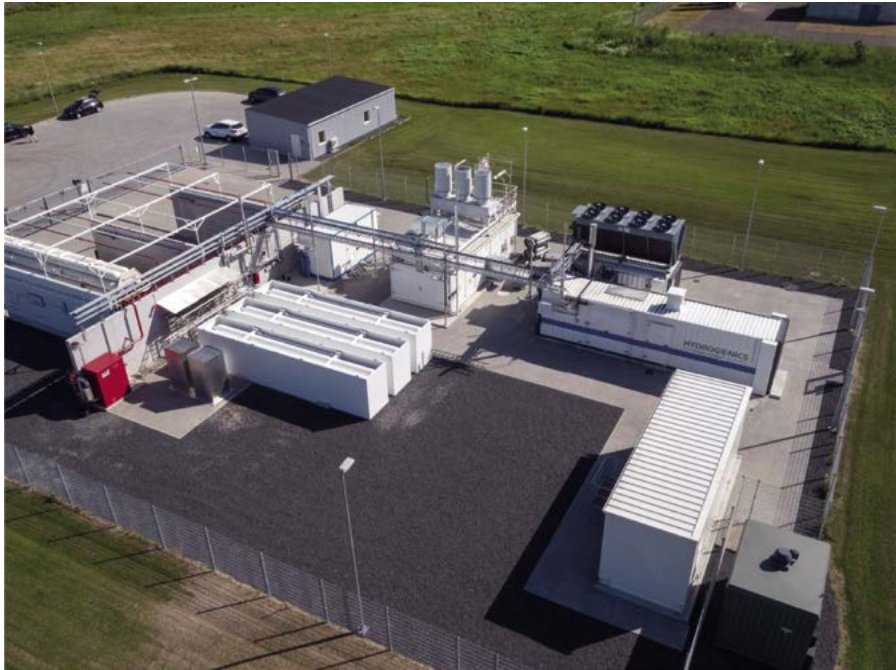
Figura 5.3 - Impianto elettrolizzatore di Hobro da 1,2 MW in Danimarca (Fonte: HyBalance)
