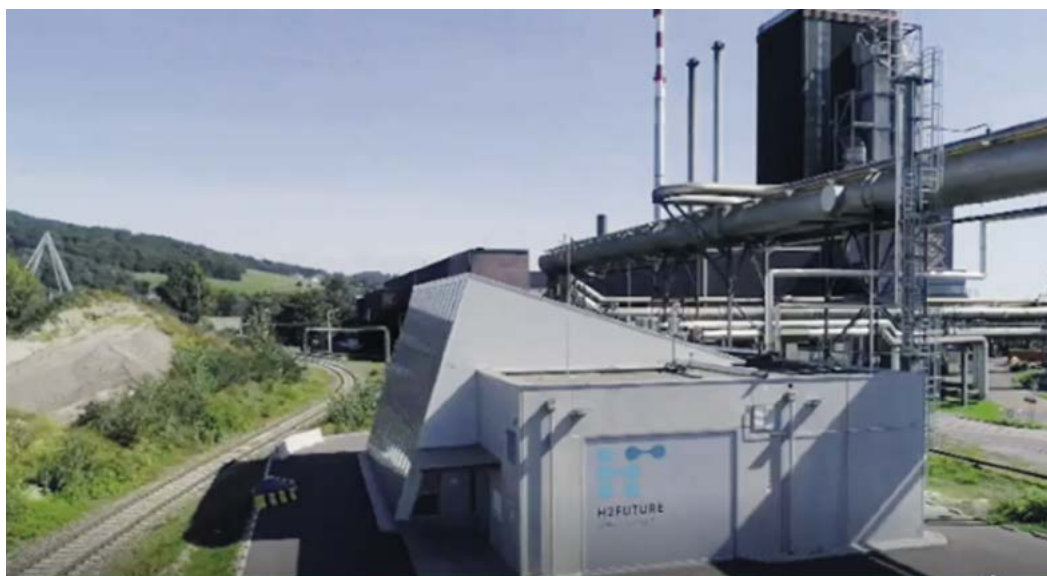
Figura 5.4 - Sito dell'impianto elettrolizzatore di Linz da 6 MW in Austria (Fonte: Fuel Cells and Hydrogen).
